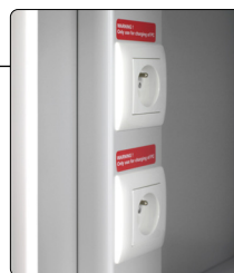
Chaque case est équipée de 2 prises électriques avec terre
